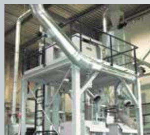
Trenntisch-Einheit mit Fördertechnik und Stahlbau
