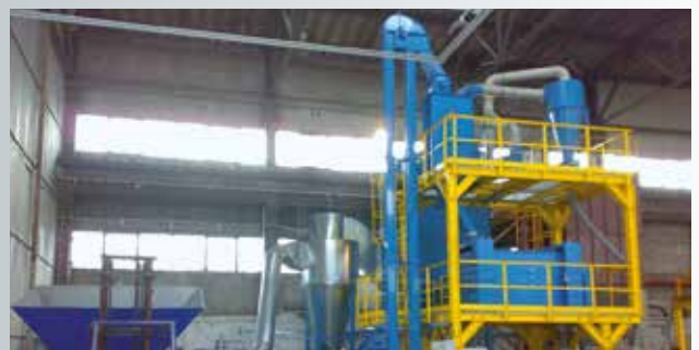
Siebtechnik mit Dichtesortierung, Fördertechnik und Stahlbau
