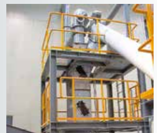
Zick-Zack-Sichter-Einheit mit Fördertechnik und Stahlbau
