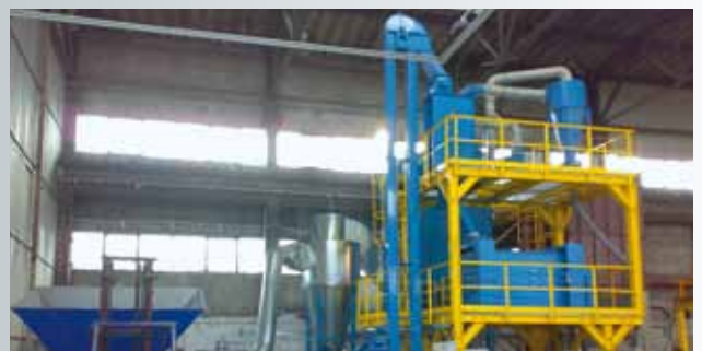
Siebtechnik mit Dichtesortierung, Fördertechnik und Stahlbau
