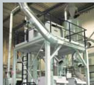
Trenntisch-Einheit mit Fördertechnik und Stahlbau
